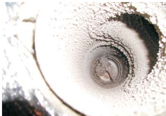
Frånluftskanal i ett FTX-system efter 3 år
