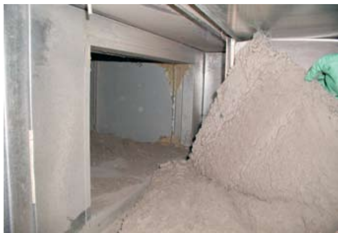
Filter i ett FTX-system efter 3 år.
